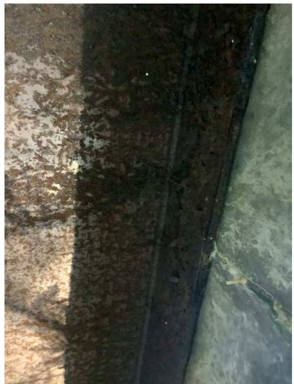
Rust scale - top flange DS side
